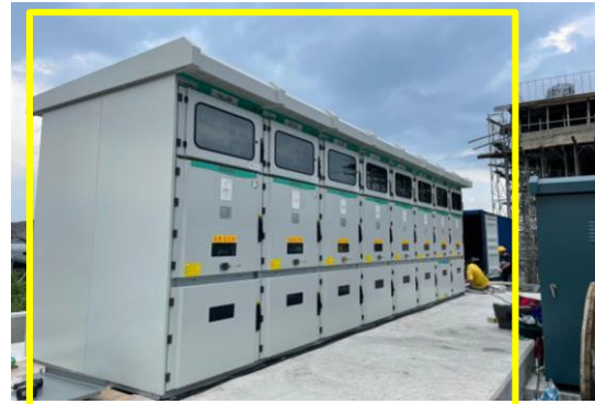
圖.1-3 高壓VCB盤採用屋外防水型高壓窄盤設計(同本校行政大樓)。
